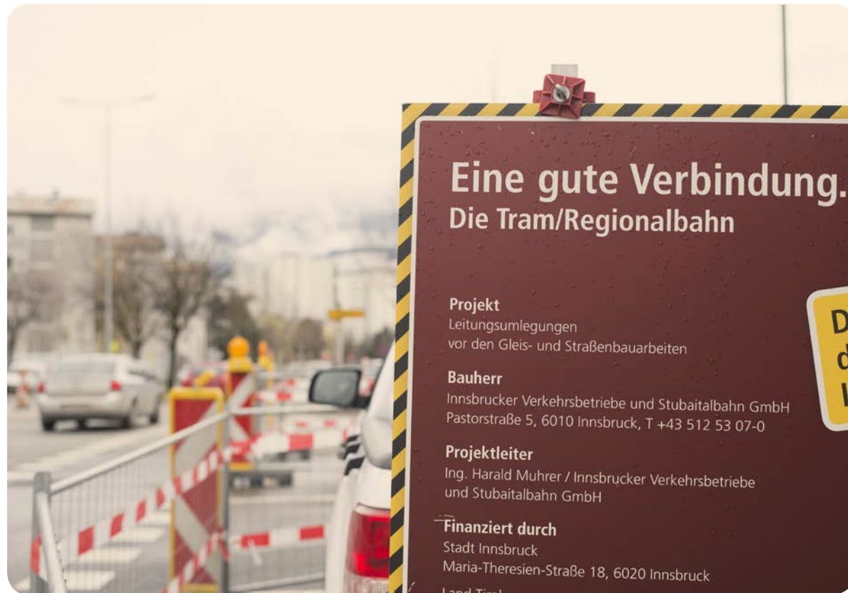
Eine große Baustelle steht im kommenden Jahr auch in der Reichenau an.
